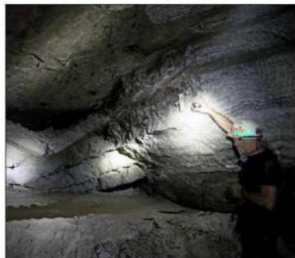
L'effondrement du toit d'une galerie de Stocamine dans les Mines de Potasse d'Alsace (MDPA) où sont entreposés des déchets ultimes. Photo L'Alsace/Thierry GACHON
