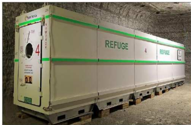
Quatre refuges pressurisés, d'une capacité de 24 personnes, ont été installés en fond de mine pour que les opérateurs puissent s'y réfugier en cas d'incident. DR
