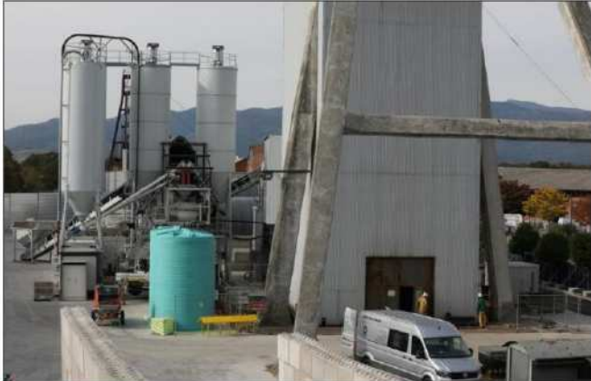
Le chantier ne pourra pas redémarrer tant que le préfet du Haut-Rhin n'aura pas signé un nouvel arrêté de fermeture comprenant des précisions sur les garanties financières de l'État. Photo L'Alsace/Vincent VOGELIN
