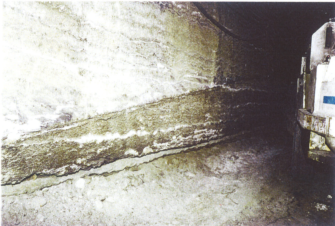
Dissolutions uniformes dans la voie d'accès au puisard du puits Joseph occasionnés par une panne de pompe d'exhaure (lame de sol de 10 cm dissoute en 48 h environ)
