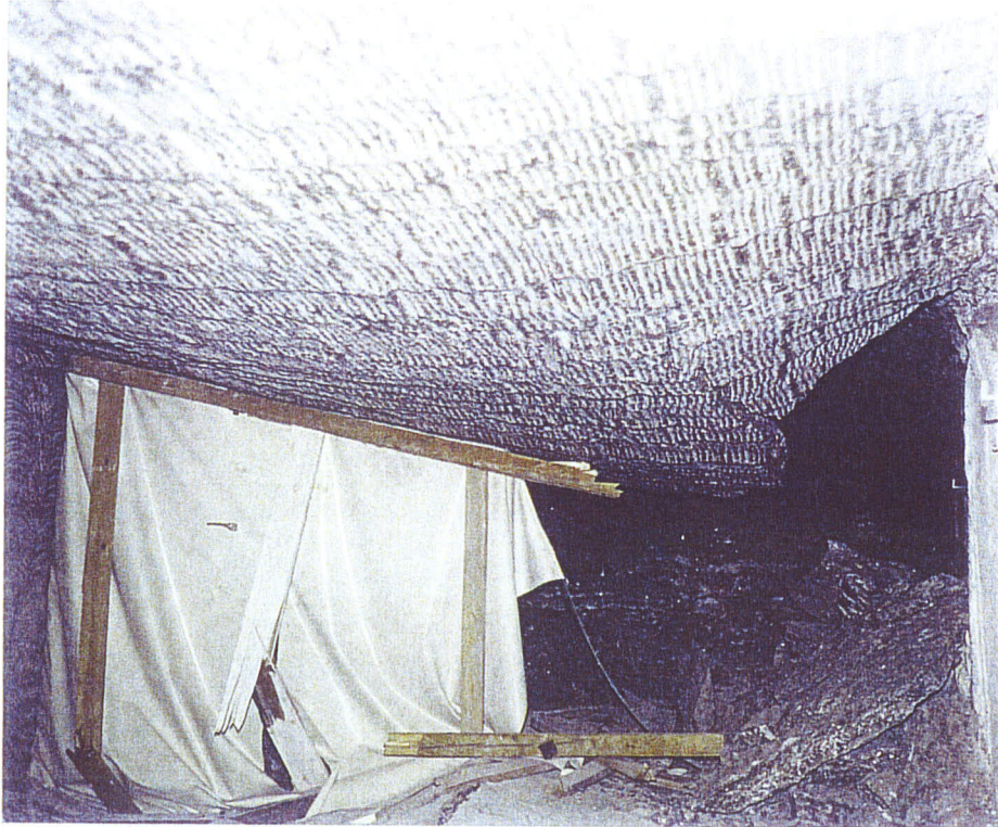
Effondrement du toit dans le bloc 26 (vide)
