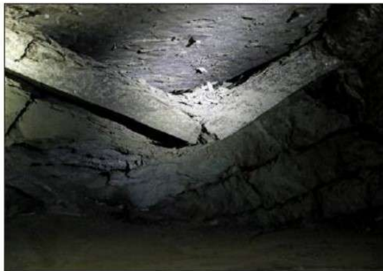
Le tribunal administratif n'a pas fait droit à l'État et à l'exploitant MDPA de l'urgence à mener les travaux de confinement en raison de la situation géologique en fond de mine. Archives L'Alsace/Thierry GACHON
