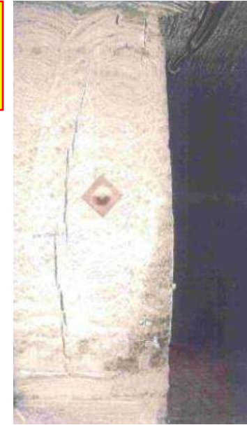
Fissuration d'un pilier carré
