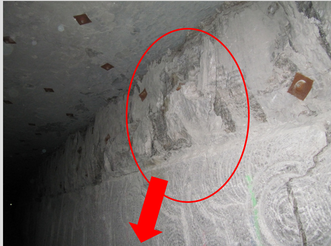
Parement supérieur fragile (risque de basculement)
