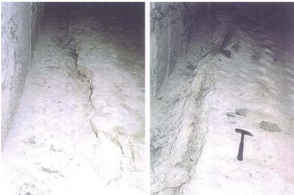
Figure 19: Décollement du toit et soufflage du mur rencontrés dans le stockage de StocaMine
